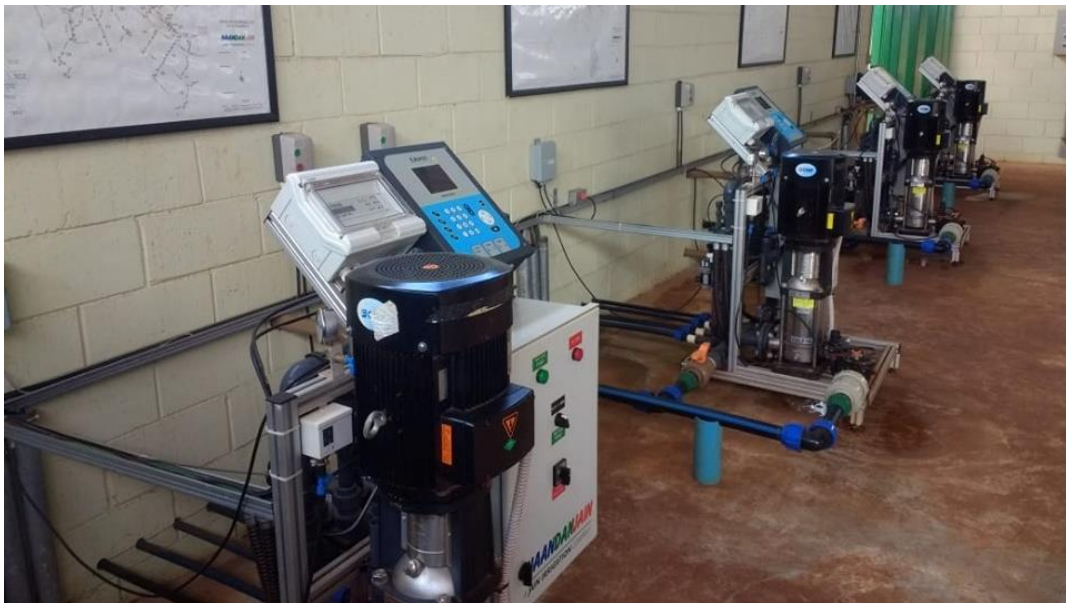
Figura 12. Central de controle e monitoramento da irrigação e fertirrigação totalmente automatizado e digitalizado, instalado em sistema de irrigação por gotejamento subsuperficial em cultura de cana-de-açúcar para alta produtividade e redução de custos de produção, em operação em empresa do setor sucroenergético no noroeste do estado de São Paulo.
