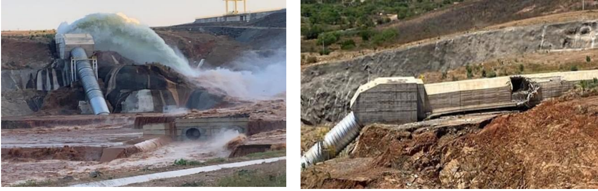
Figura 3. Detalhes do rompimento da adutora da hidroelétrica da Barragem do Jati, Ceará, Projeto de Integração do Rio São Francisco
