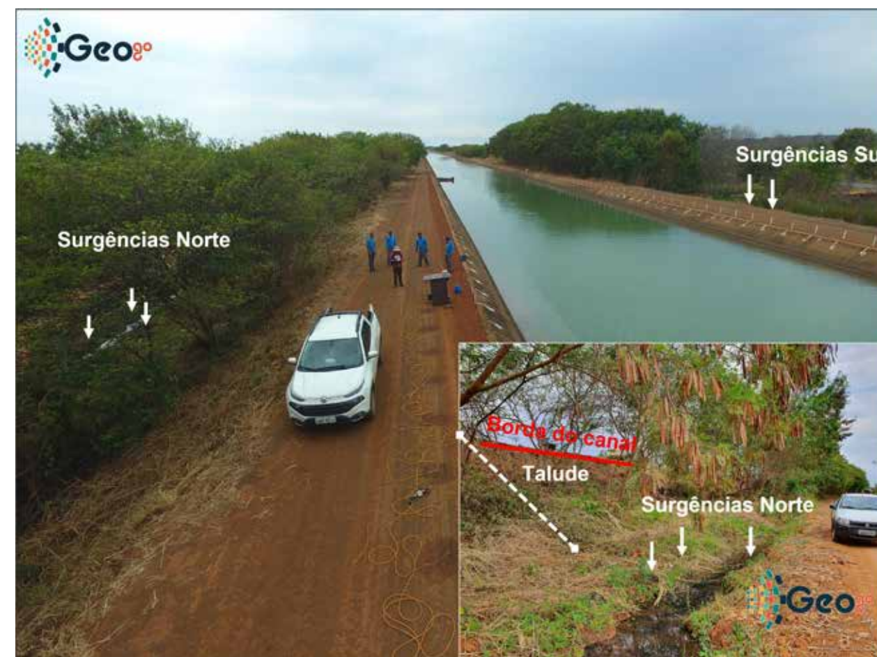
Figura 3 – Imagens das áreas de surgências de água nos sopés dos taludes no DIJ2, em outubro de 2019
